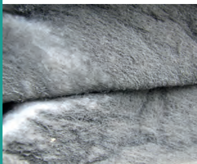
Bei der jährlichen Inspektion ist es notwendig, die betreffende RLT-Anlage einer kompletten Bestandsaufnahme zu unterziehen.
